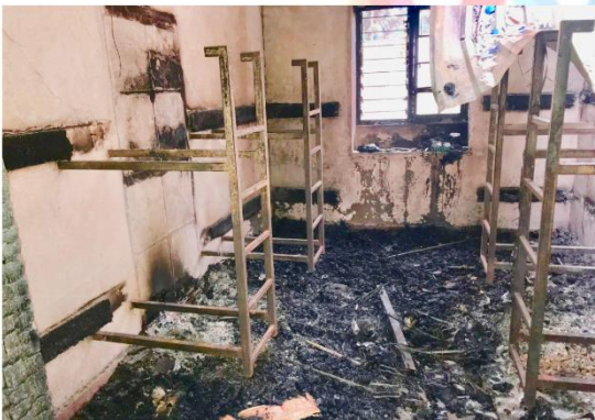
Eines der Zimmer, beschädigt und reparaturbedürftig.
